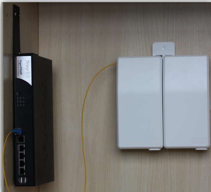
Eindresultaat installatie Vigor 2960F i.c.m. uFTU
